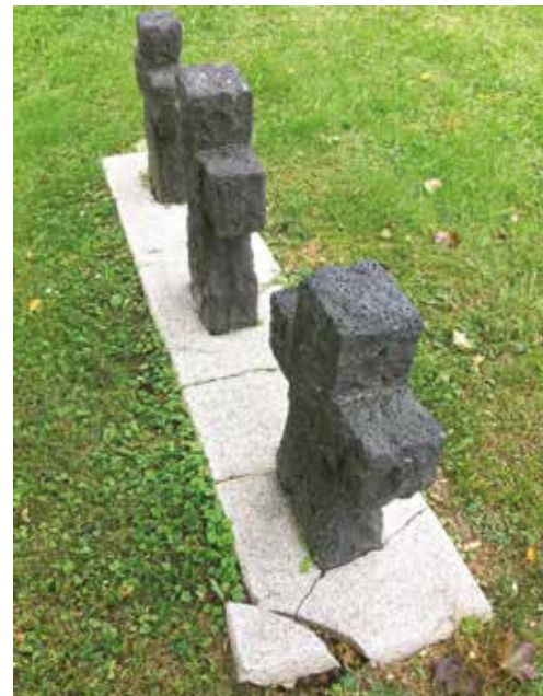
Das gebrochene Betonfundament einer Dreier-Basaltkreuzgruppe (links) und die Schalung für notwendige Betonierarbeiten (unten)
